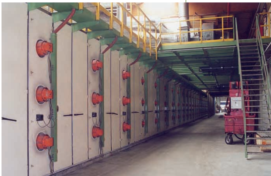
Horno de secado del tablero de fibras de madera en húmedo.
